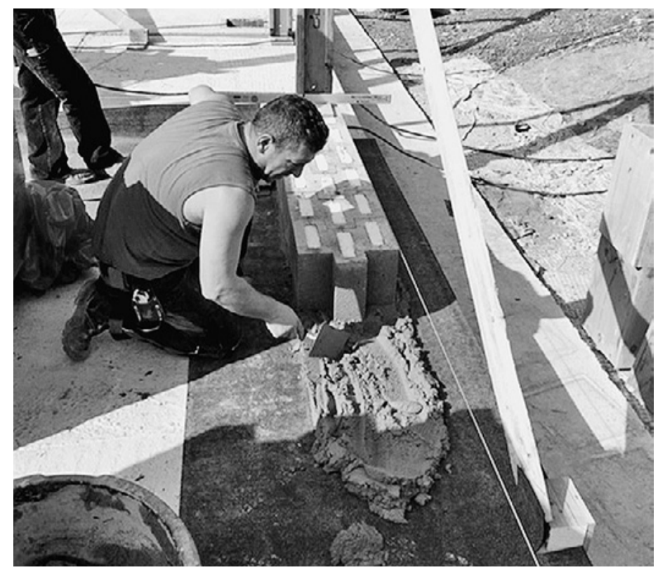
Der Bisorocket wurde vom Bauherren bewusst ausgewählt, damit das durchdachte Wohnkonzept auf der soliden Rohbauqualität „Made by Bisotherm“ fußt und sich die Bewohner zukünftig ganzjährig in ihren Neubauwohnungen pudelwohl fühlen.
