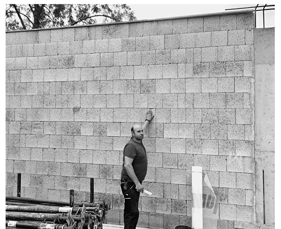
Hochwertiges Bisoplan-Außenmauerwerk der Marke Bisotherm der Wanddicke 42,5 cm wird künftig für ein angenehmes Lernklima – Sommer wie Winter – sorgen. Polier H. Liesenfeld von der Bauunternehmung Alex Wolf ist begeistert von der Maßhaltigkeit und der Steinqualität: „So macht unsern Maurern die massive Rohbauausführung Spaß und geht leicht von der Hand“.
