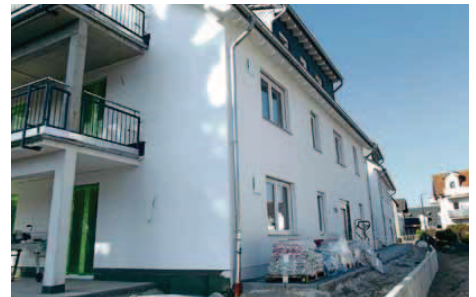
Nach wenigen Monaten Bauzeit sind die beiden Mehrfamilienhäuser bis auf ein paar Innenaussparbeiten und die Außenanlagen fertig gestellt.
